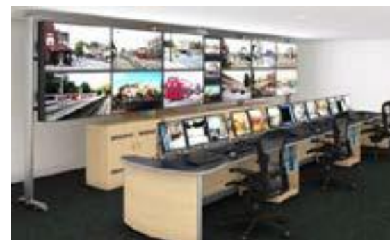
Centre de surveillance
